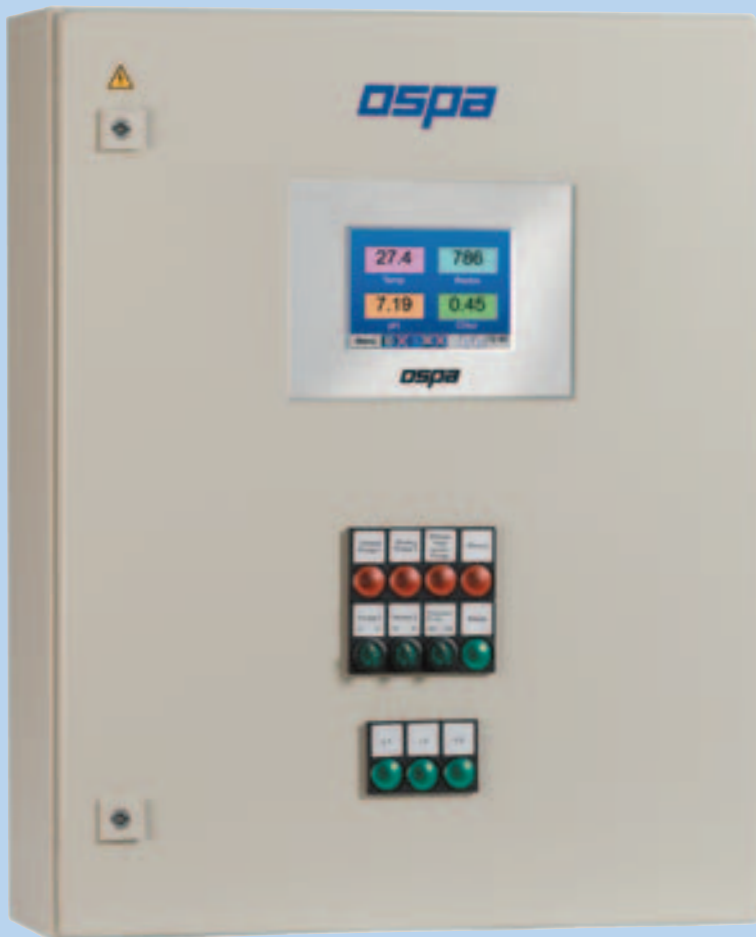
Ospa-Steuerschrank mit eingebautem Ospa-BlueControl®-Pilot
